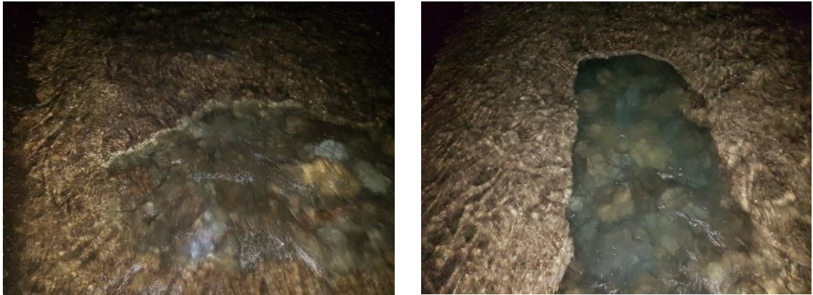
ფოტო 6-4: ბეტონის ძირის დაზიანება რომლის ქვემოთაც შეიმჩნევა ძირითადი ქანები. დაზიანების ტიპი II; პკ 63+70 (მარცხნივ); დაზიანების ტიპი II; პკ 73+20 (მარჯვნივ)
